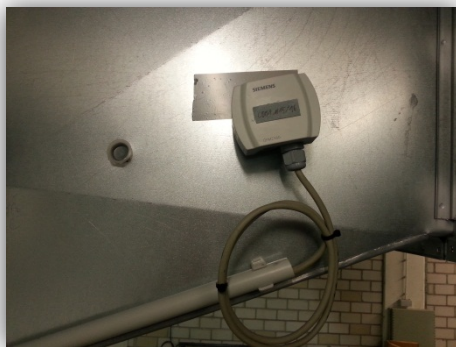
Bild 16: Feldgerät im Kanal mit Messöffnung
