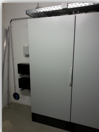
Bild 8: DDC Schaltschrank geschlossen
