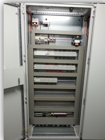
Bild 9 DDC Schaltschrank geöffnet
