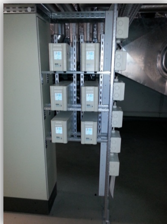
Bild 14: Beispiel Aufstellung USV neben DDC Schaltschranken
