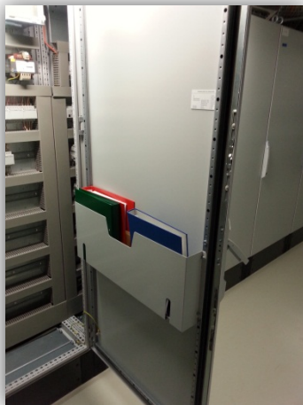
Bild 10: Ausführung Schaltschrank mit Schaltplantasche
